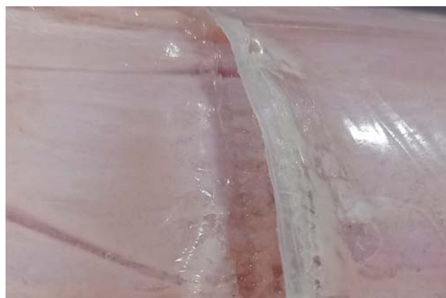
Imagen 35. Rotura de soldadura.
